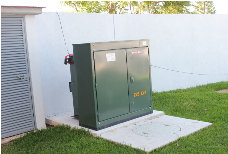
Figura 11. Transformador eléctrico ubicado en CUAAD.
