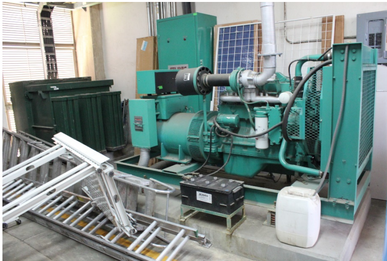
Figura 43. Planta de emergencia de luz alimentada diésel en CUCEA.
