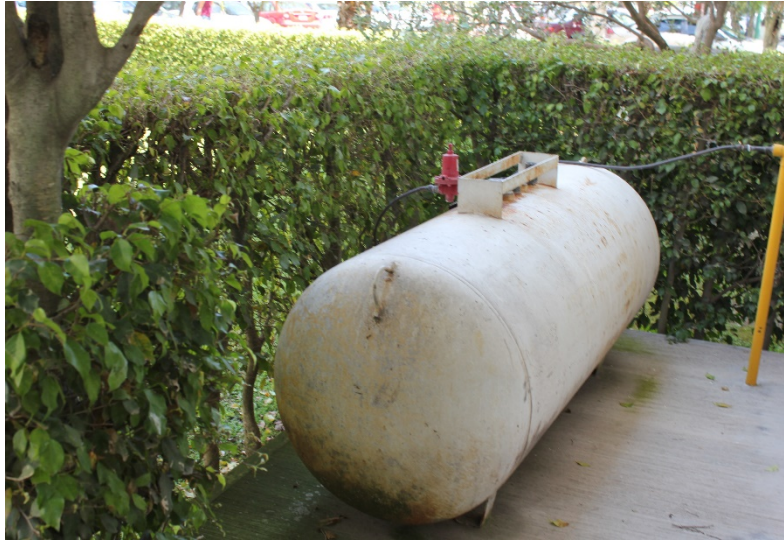
Figura 42. Instalaciones de almacenamiento de Gas LP en CUCEA.
