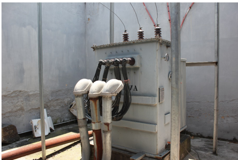
Figura 46. Transformador eléctrico ubicado en CUCEA.
