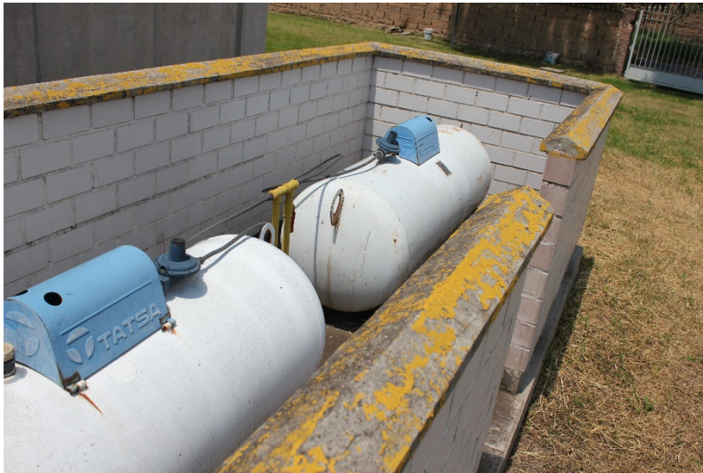
Figura 25. Instalaciones de almacenamiento de Gas LP en CUCBA.
