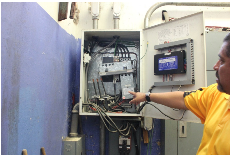
Figura 89. Tablero de control de planta de emergencia de luz alimentada diésel en CUCSH.
