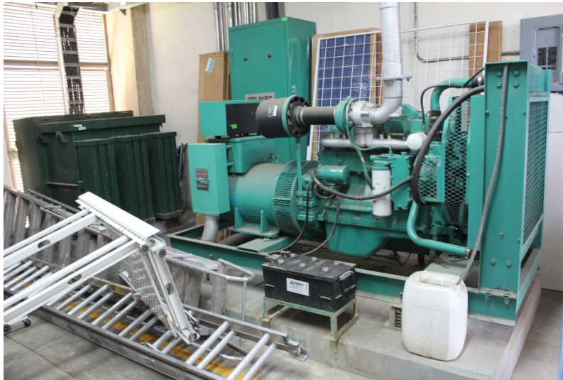
Figura 60. Planta de emergencia de luz alimentada diésel en CUCEI.
