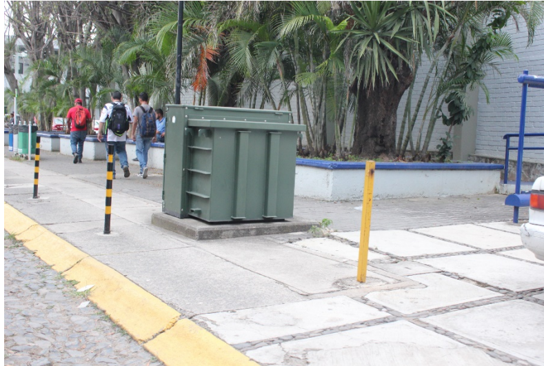
Figura 63. Transformador eléctrico ubicado en CUCEI.
