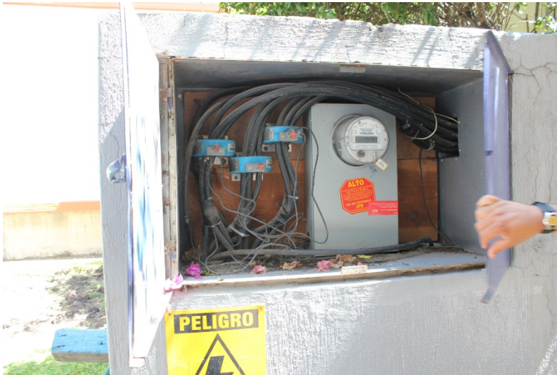
Figura 93. Medidores de electricidad en CUCSH.
