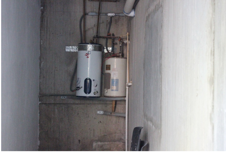
Figura 8. Boiler para calentamiento de agua en CUAAD.
