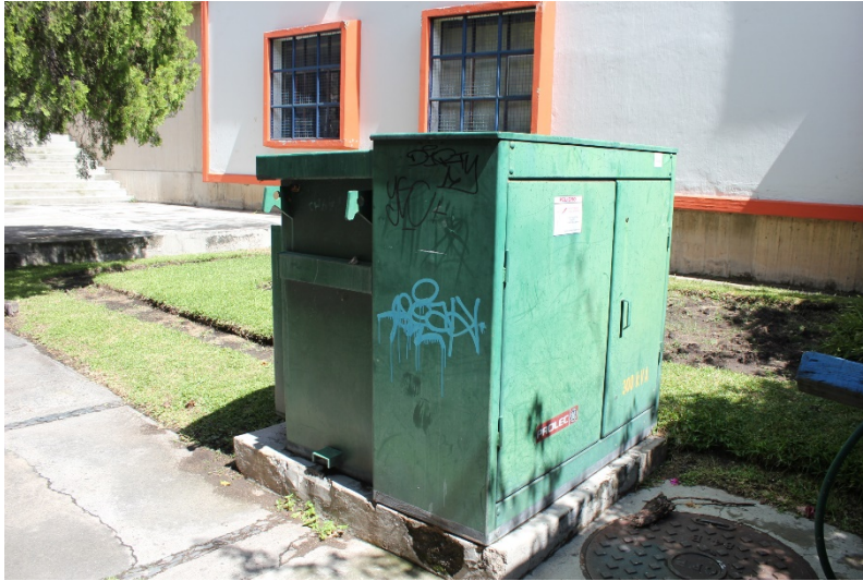
Figura 92. Transformador eléctrico ubicado en CUCSH.
