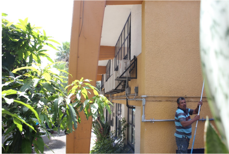
Figura 91. Equipos de fuentes de emisión fugitiva. Aires acondicionados en CUCSH.
