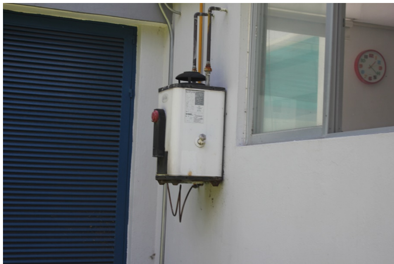
Figura 45. Equipos de fuentes de emisión fija. Calentador de agua para las instalaciones de CUCEA.
