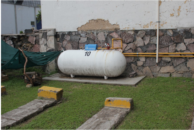
Figura 59. Instalaciones de almacenamiento de Gas LP en CUCEI.
